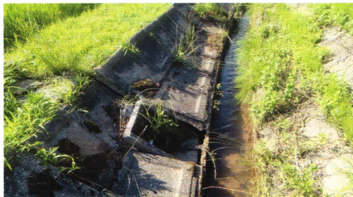
◎ 排水路の張りブロックの陥没
