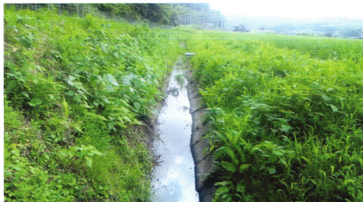
◎ 高低差不足の排水路。張りブロックの落下
