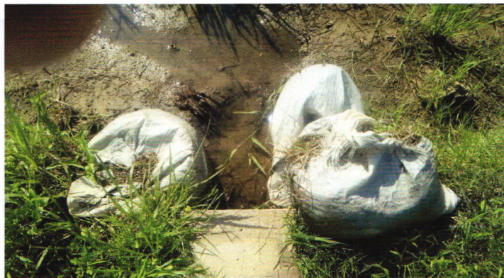
◎ 排水マスの落下。
