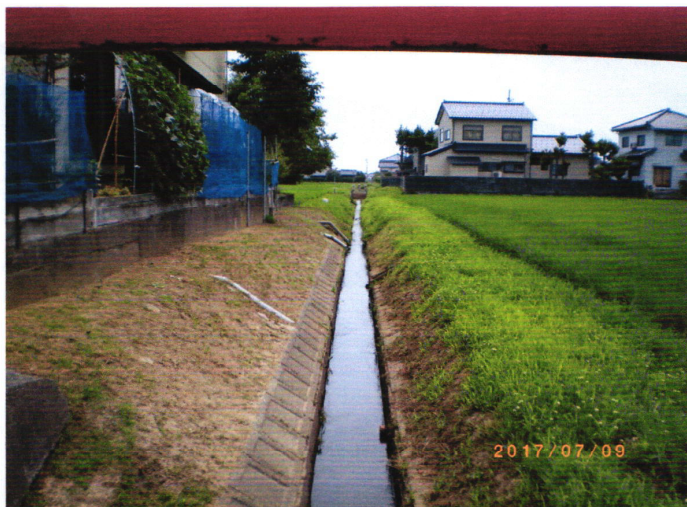
◎ 通常時の排水路。
